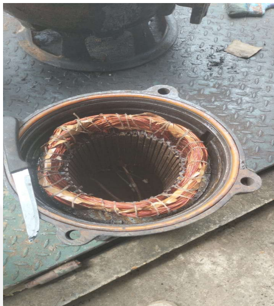
Bobina del equipo de 25hp de la estación coroncoral .
