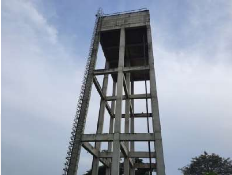
Ilustración 1. Tanque Elevado Cab Mpal ESTACION CRISTO REY
